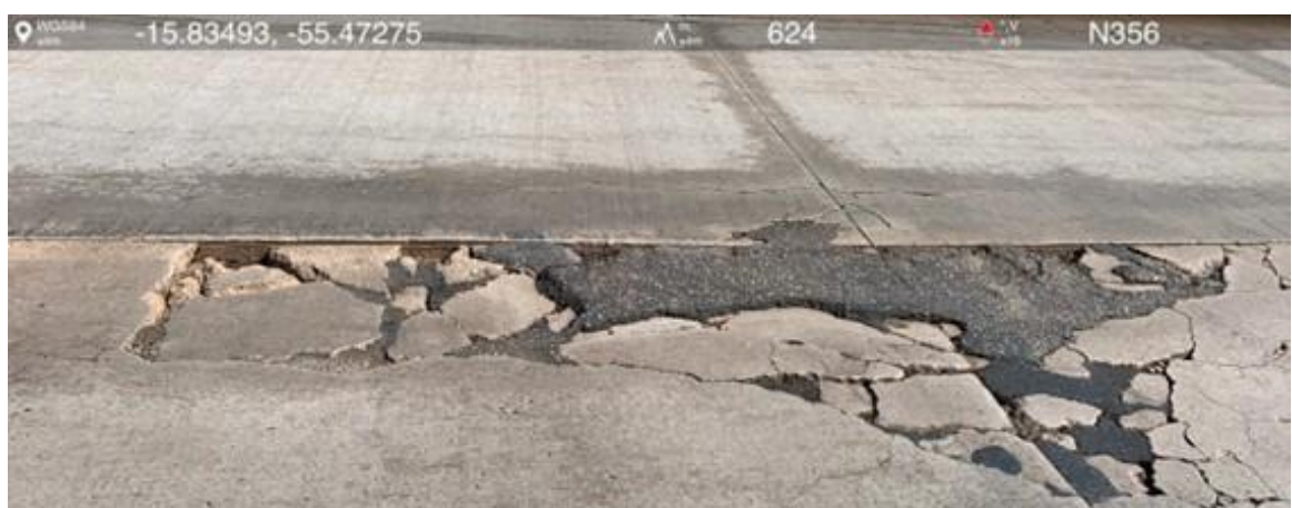
Figura 8 – Trecho de Ida da rodovia – Próxima à Serra de São Vicente - Trincas, quebra localizadas e buracos
