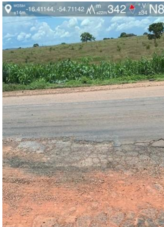
Figura 14 – Trecho de Volta da rodovia – Próximo à Rondonópolis -Trincas, desgastes e erosões
