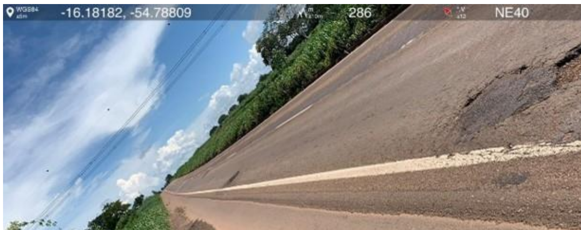
Figura 12 – Trecho de Ida da rodovia – Próximo à Juscimeira - Remendos, afundamentos, desgastes
