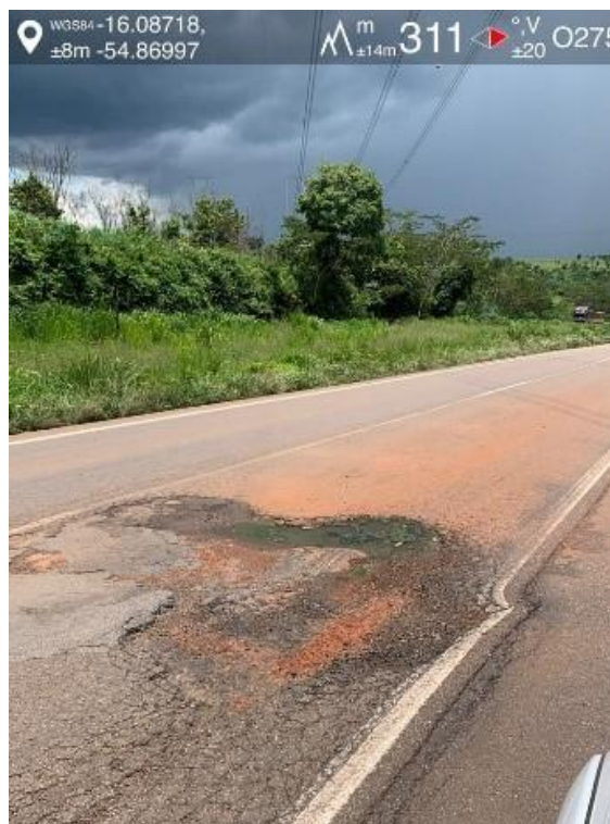
Figura 15 – Trecho de Volta da rodovia – Próximo à Juscimeira - Trincas, desgastes, buracos, erosões
